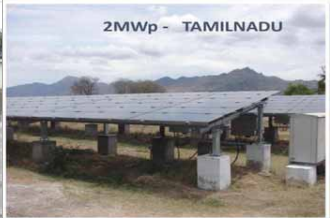
2 MEGAWATTS - MADURAI TAMILNADU, INDIA
